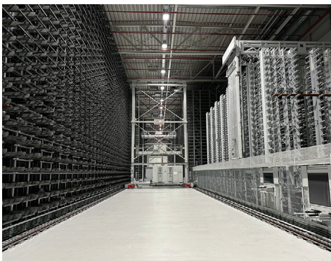
Le magasin KASTOunicompact compte 5 140 places sur 20 m de haut (chaque tiroir peut accueillir une cassette de trois tonnes).
