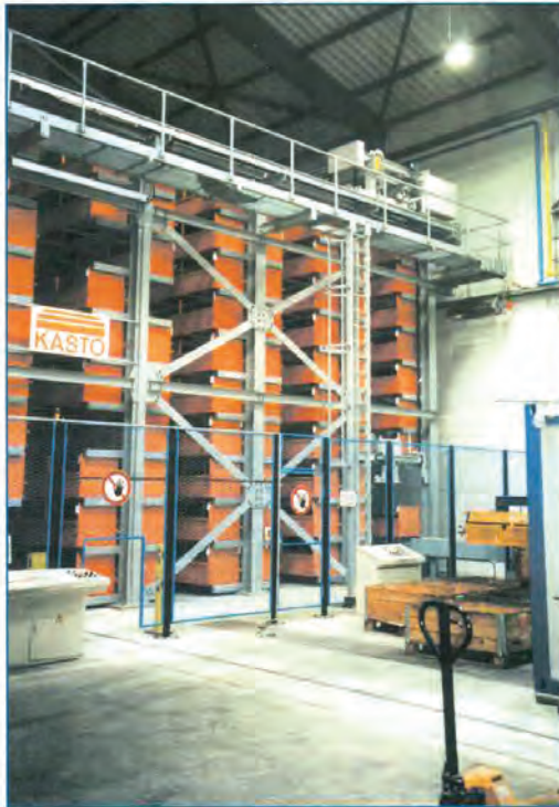
Côté droit des rayonnages de l'installation Kasto-Unitop avec transtockeur, construction métallique, passerelle d'entretien et deux stations d'évacuation à course longitudinale.
